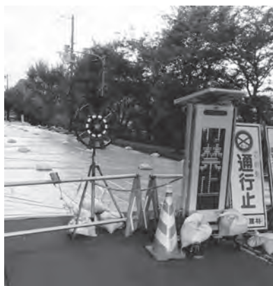
●箕面市立病院の移転先になっている、COM1号館近くの船場東1丁目10。新船場北公園(調整池)南側法面の一部と南側歩道の一部が約35m崩落。道路も通行止め。北急工事には地震の影響はない、とのこと。
